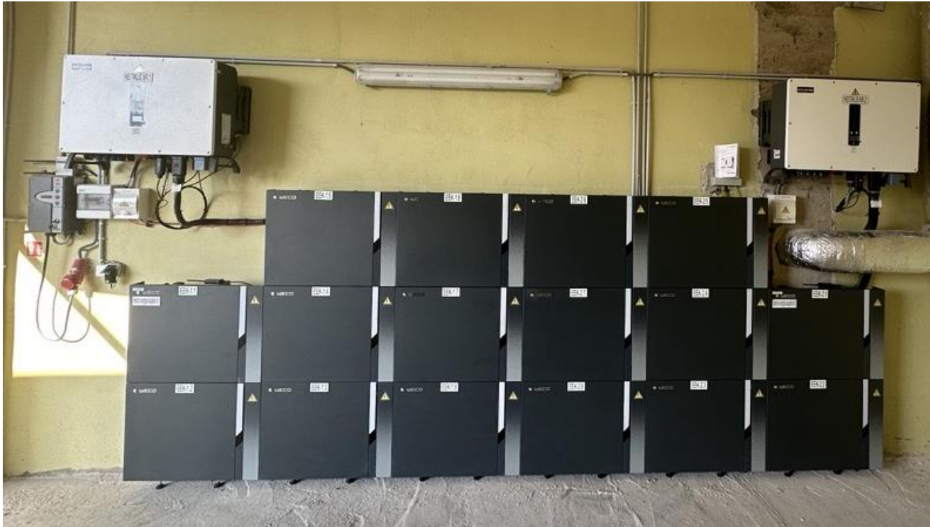
Baterijos talpa 80 kWh (2x40 kWh), 40 kW
